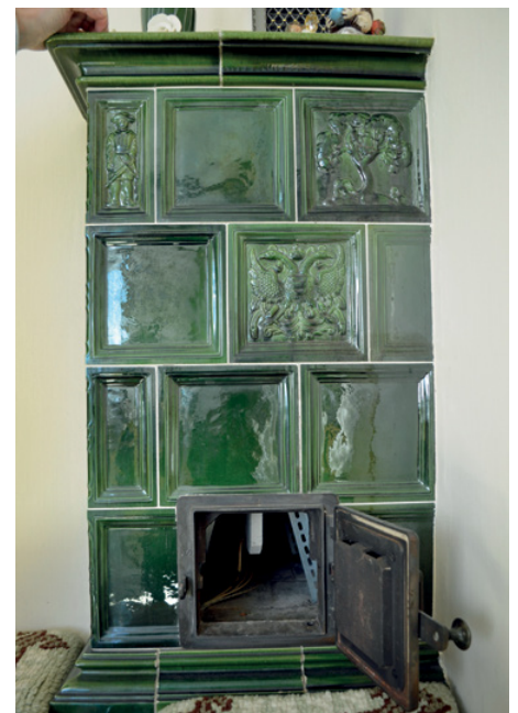
Der stillgelegte Kachelofen wurde mit einer elektrischen Heizung ausgestattet, die bei Bedarf mit dem (Überschuss-) Strom der eigenen PV-Anlage betrieben wird.
