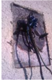
Der Blower-Door-Test offenbarte nicht nur, dass immens viel Energie über die Elektroverrohrung verloren ging, sondern förderte auch eine gefährliche Kondenswasserstelle bei einem elektrischen Verbraucher zu Tage.
