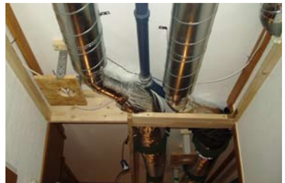
Die Installation der Zu- sowie der Abluftleitungen erfolgte großteils mit glatten Rundrohren, die gedämmt wurden. Damit die Leitungen später nicht mehr zu sehen sind, ist auch eine neue Deckenkonstruktion zu berücksichtigen.
