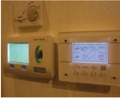
Komfort-Schaltzentrale im Haus der Familie Lang: Oben, die Regelung für die Frau, die sich mit Technik bewusst nicht näher befassen möchte; unten die Steuer-/Regelungstechnik für den Mann, der via CAN-Monitor (li unten) in die Haustechnik bzw. Wohnraumlüftungsanlage (Steuerung re unten) eingreifen kann.
