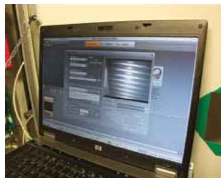
Im Verdampfer hat Herr Lang eine Videokamera installiert. Mühelos kann er sich so jederzeit optisch informieren, wann es (bei welchen Wetter-/Temperaturverhältnissen) zu einer etwaigen Vereisung des Verdampfers käme.
