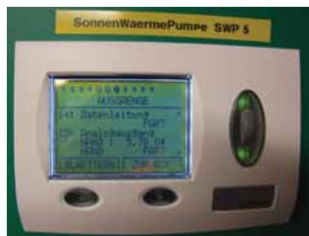
Der Regler übernimmt das Wärmemanagement für den Pufferspeicher.
